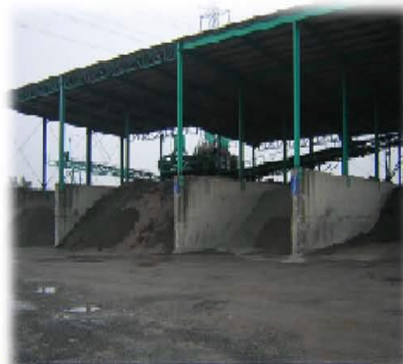
阻隔牆未完全圍封堆置區
