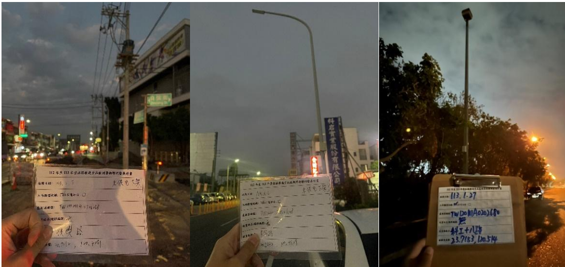
圖3-34 供電異常點位
