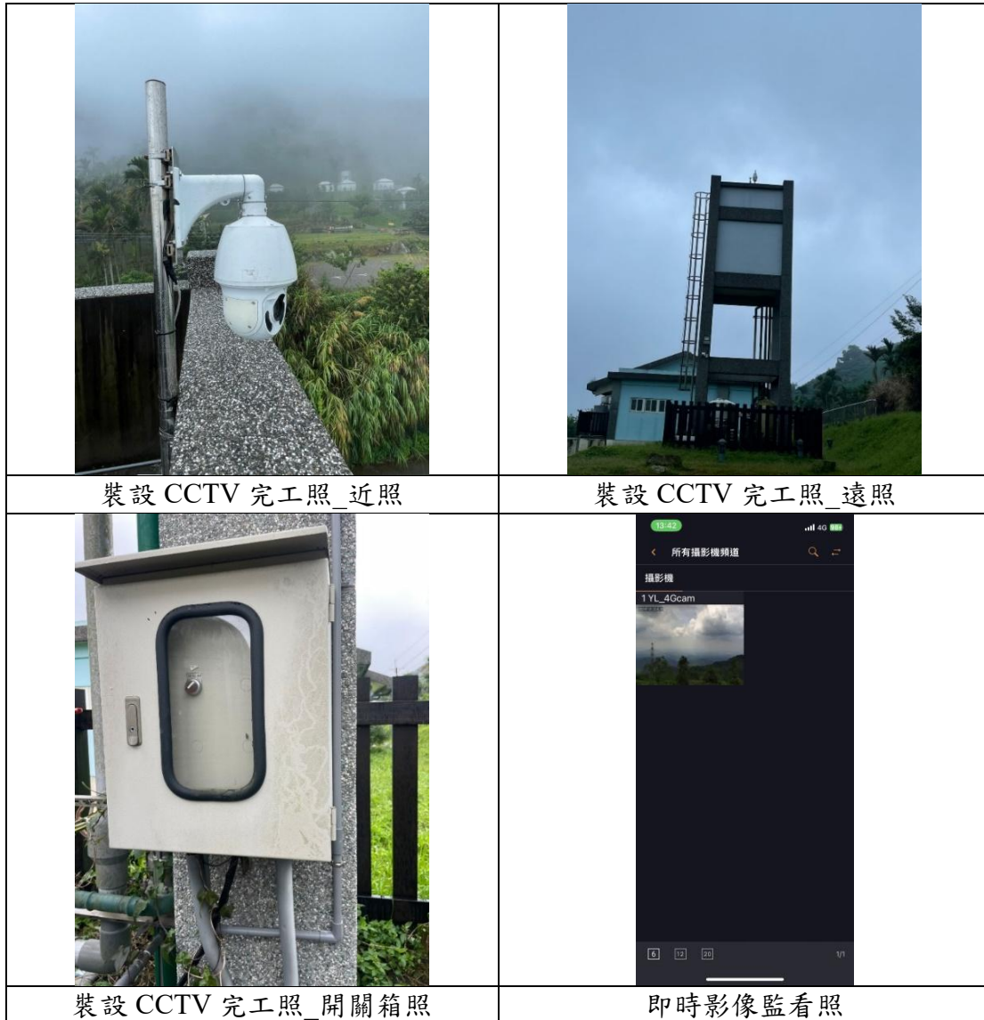
圖3-44 即時影像監視器(CCTV)裝設照片
