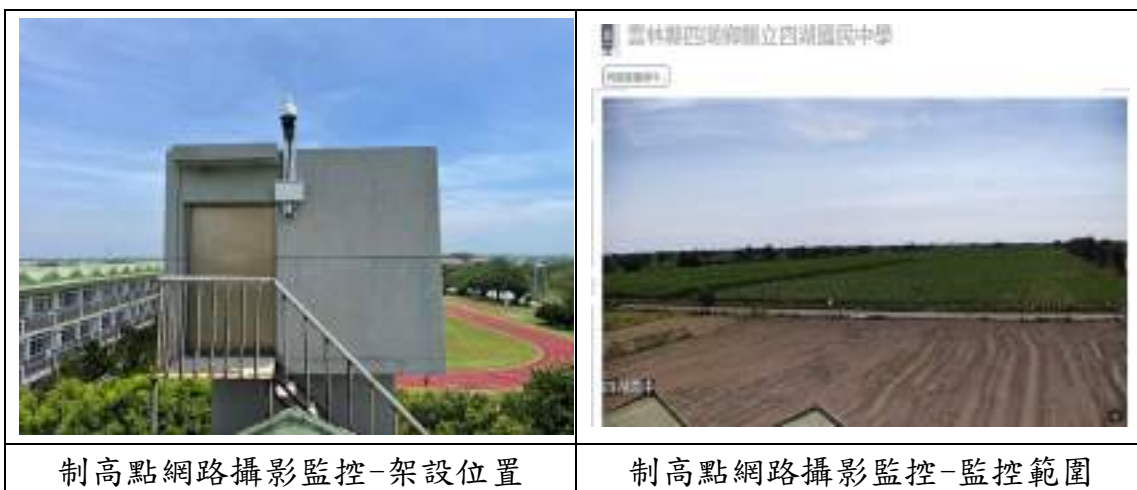
圖 3.4.2-13 AI 煙霧主動通報系統安裝情形(四湖國中)
