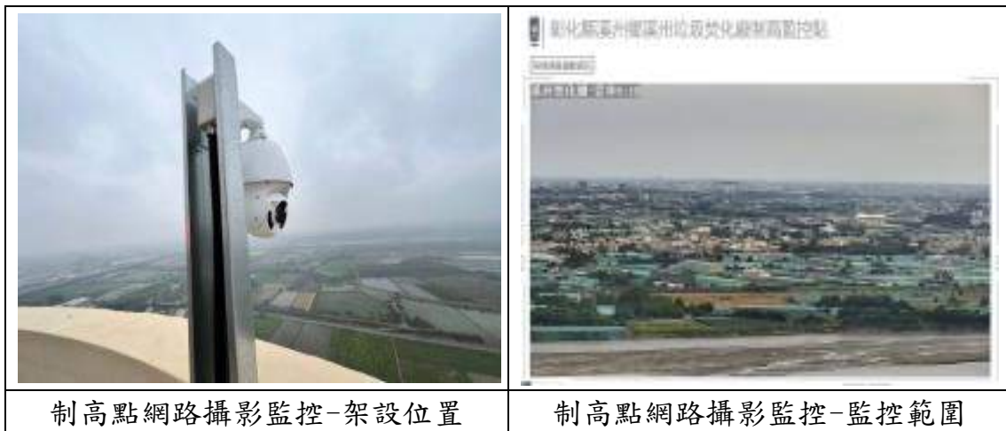
圖 3.4.2-13 AI 煙霧主動通報系統安裝情形(溪州資源回收(焚化)廠)
