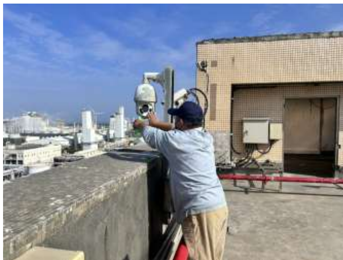
圖 5.6-2、廢氣燃燒塔 AI 自動監控系統清潔維護情形
