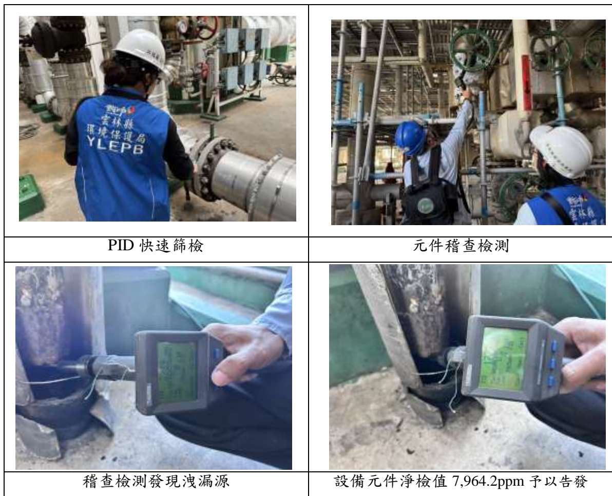
圖 5.4-1、設備元件稽查檢測作業
