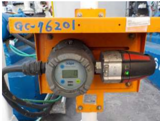
圖 6.3-2、含氯廢水處理設施氣體偵測設備設置情形
