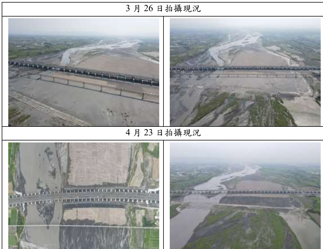
圖 9.1-2 第 M16 標國道 1 號中沙大橋耐洪與耐震能力提升改善工程暨西螺交流道穿越橋改建工程 空拍作業變化對照圖
