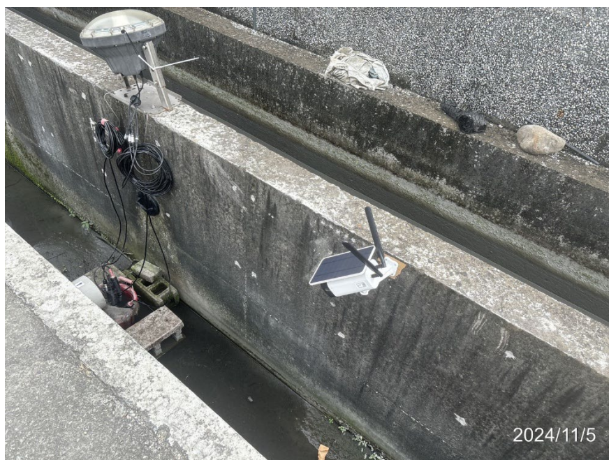
圖4.7-2 太陽能無線攝影機架設情形
