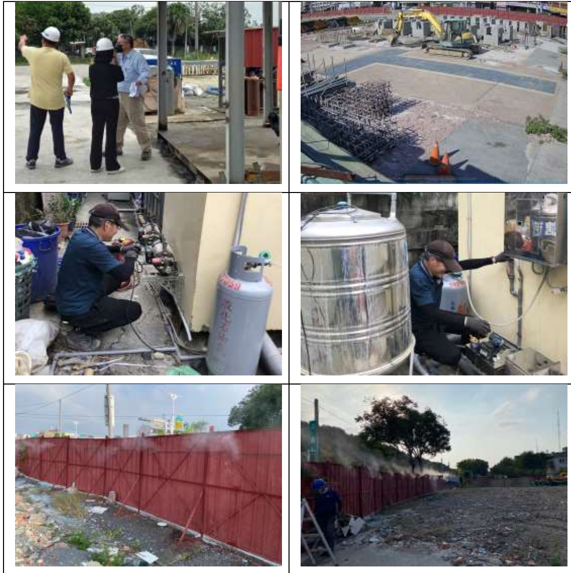
圖 9.2-3 第 3 處營建工程運用科技化空氣污染防制設施照片
