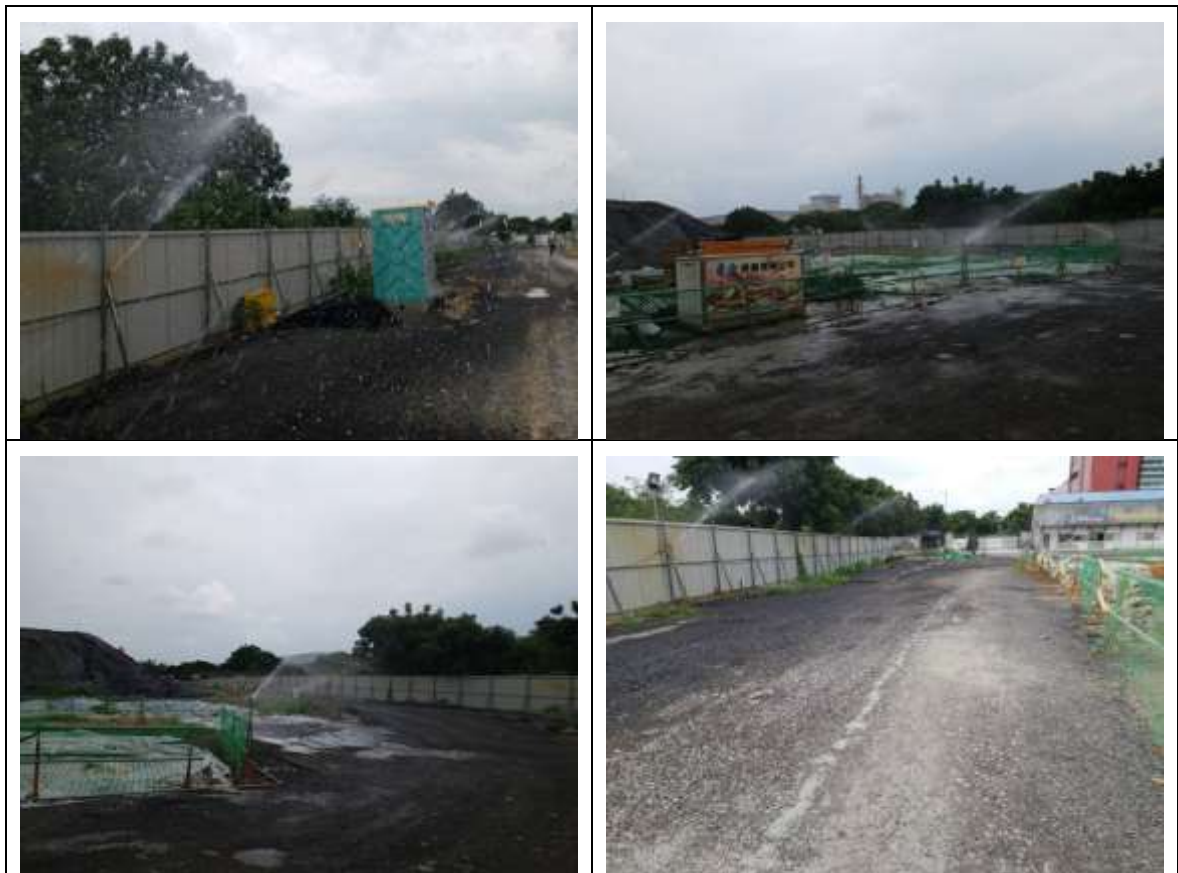
圖 8.9-1 設置移動式加壓噴霧灑水設備照片
