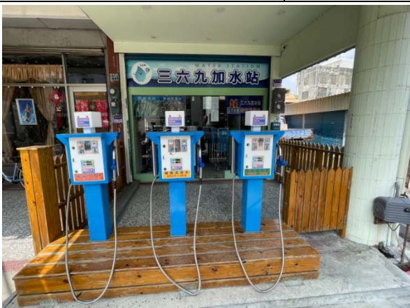
加水站設備遠照
