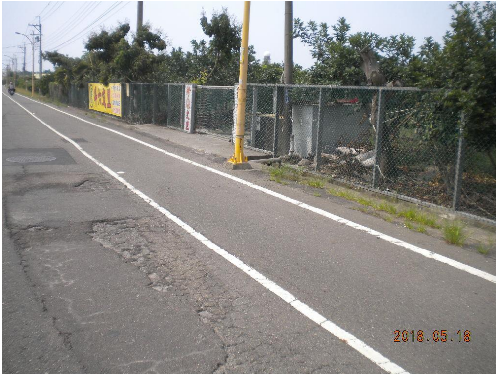
圖 6.4-2 道路破損情形(縣 154 乙 14.5K 處)
