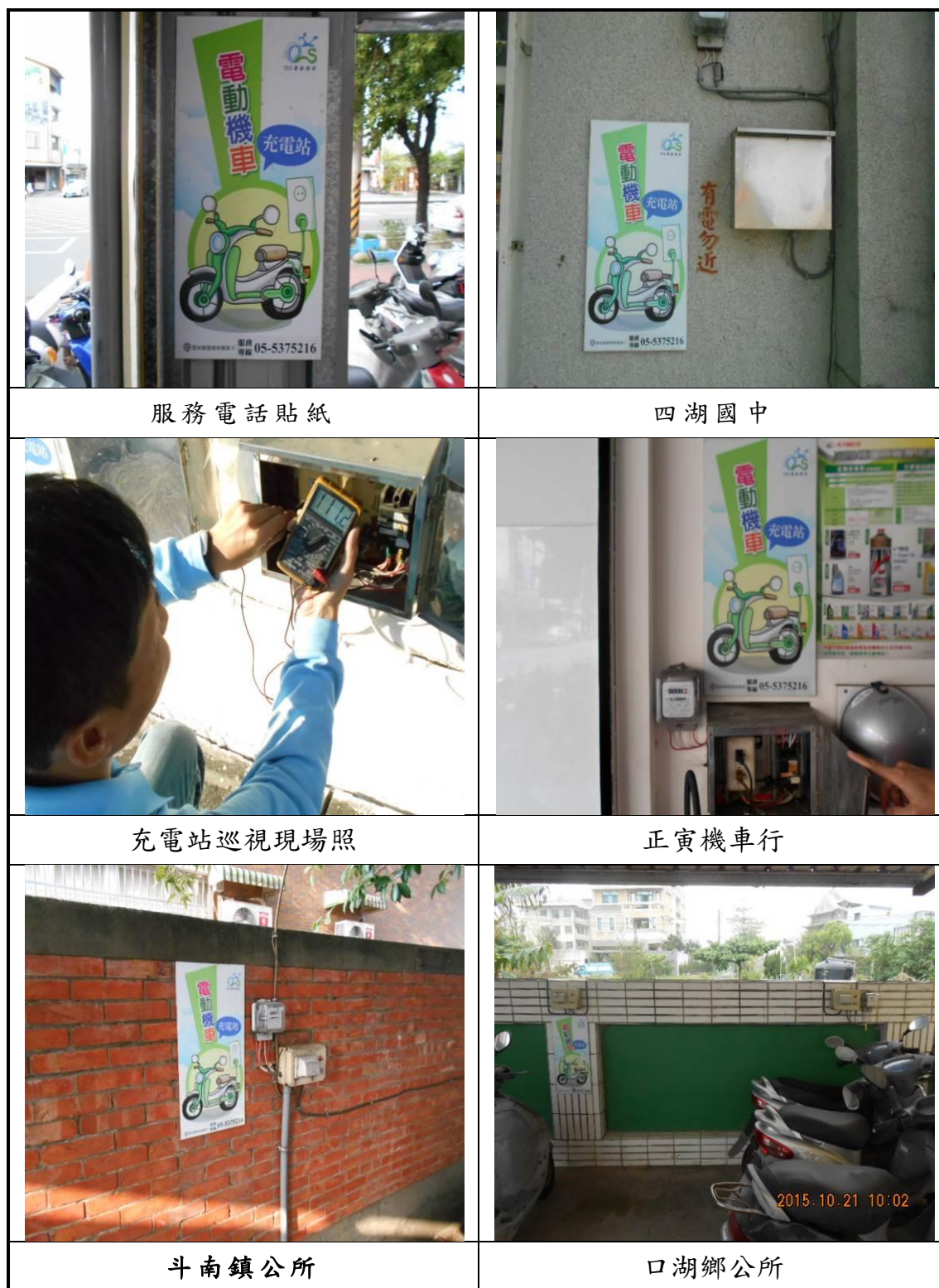
圖 4.26-1 電動機車充電站巡視維護照片
