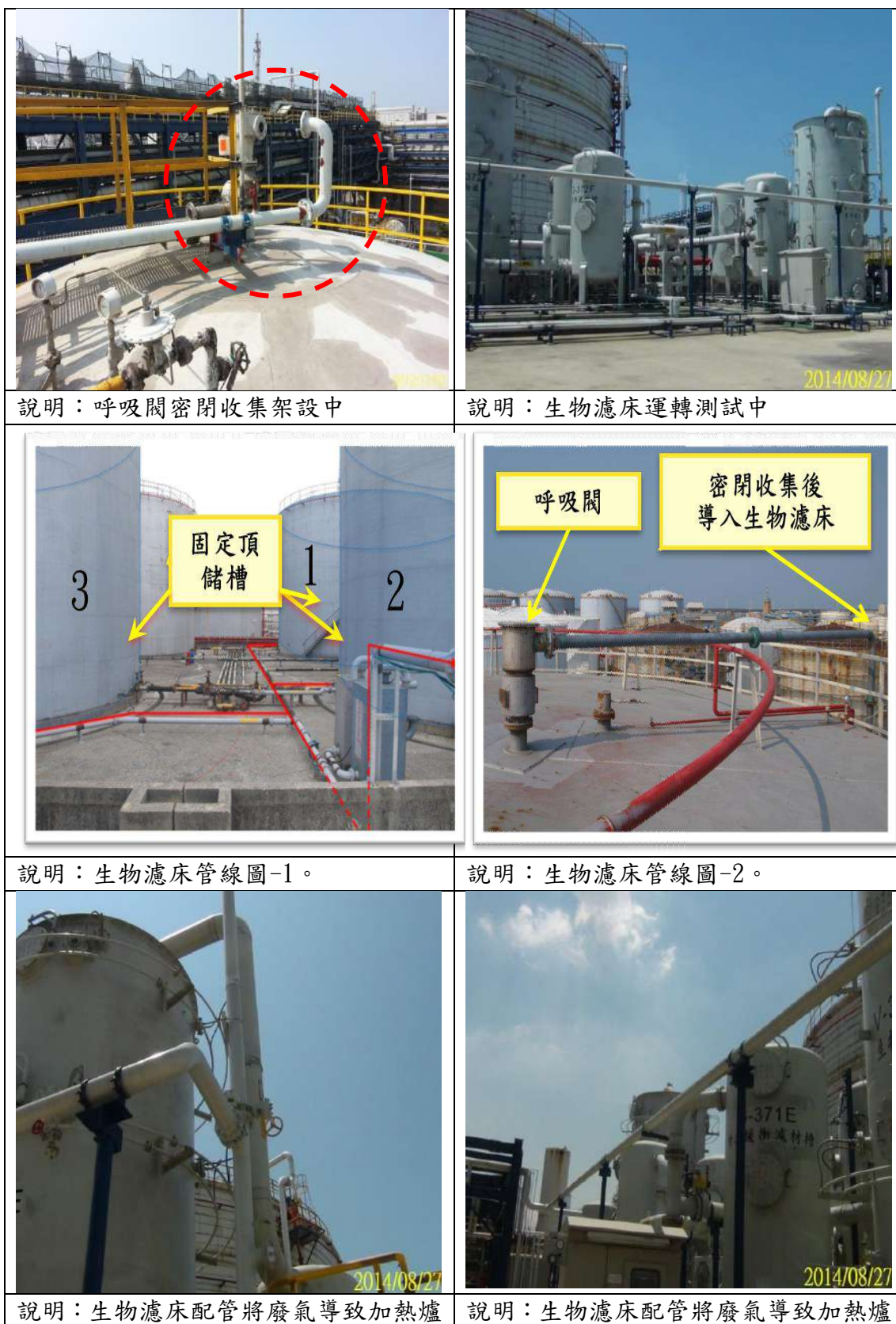
圖 4.4-1、台化 SM 廠儲槽改善追蹤-1
