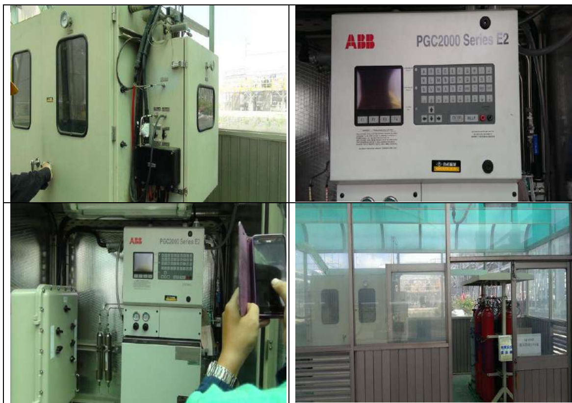
圖 3.3-3、塑化 OL-1 廠線上監測設施
