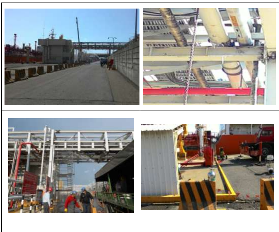
圖 4.1.2-4、西北碼頭 LPG 洩漏現場
